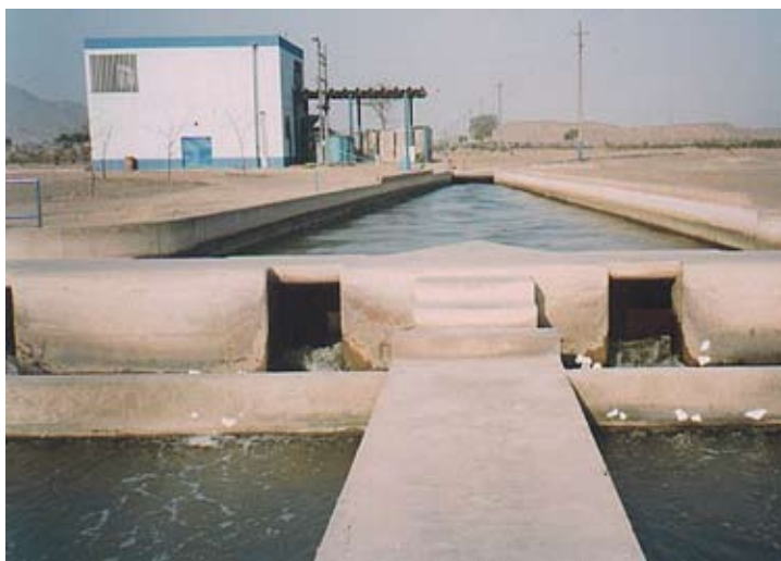
Figura 2. Imagen de una parte de la batería de 12 desarenadores de la Planta de Tratamiento de Aguas a partir del canal único de acceso.
