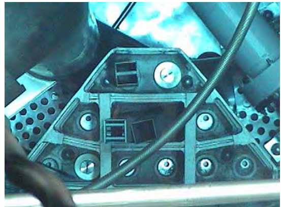
Cementerio de Elementos Combustibles Tanque Principal N° 2 RACK 36 y 37
