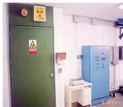
Figura 1: Sala de control de la Planta GB-127.
