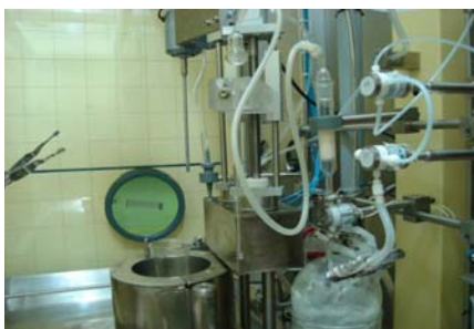
Figura 6. Sistema químico instalado dentro del recinto blindado.
