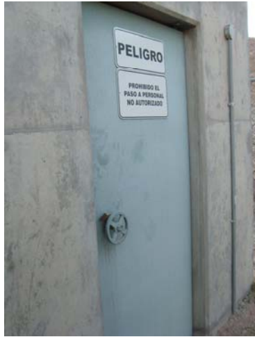
Figura 5. Puerta con blindaje de plomo.
