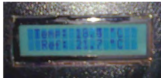
Figura 5. Visualización del sistema de control de temperatura.
