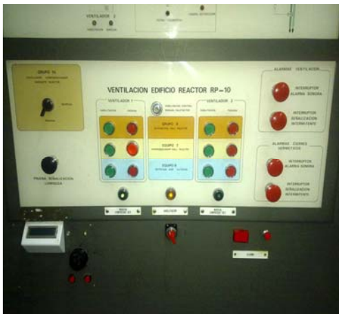
Figura 1. Imagen del tablero de control del sistema de ventilación del edificio del RP-10. Se observa, al medio, los pulsadores de arranque y parada de los ventiladores.
