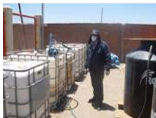
Figura 1. Tanques de lixiviados.
